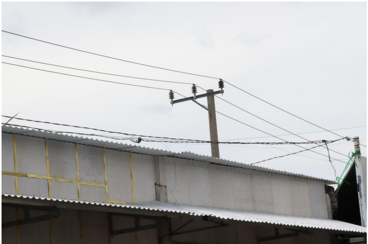
Hiện trạng khoảng cách lưới điện (đoạn thấp nhất) đến mái tôn nhà dân là 3 mét. Theo kế hoạch trong tháng 10/2022, Điện lực Vạn Ninh sẽ cho lắp thêm chụm đầu cột 1,5 mét. Như vậy, tổng khoảng cách độ võng dây cách mái tôn là 4,5 mét.
