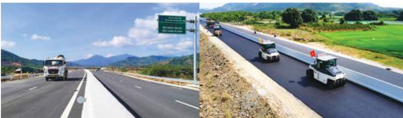
Cao tốc Nha Trang – Cam Lâm dài khoảng 49,1 km đi qua các huyện Diên Khánh, Cam Lâm và TP. Cam Ranh * Tổng mức đầu tư khoảng 7.615 tỷ đồng
